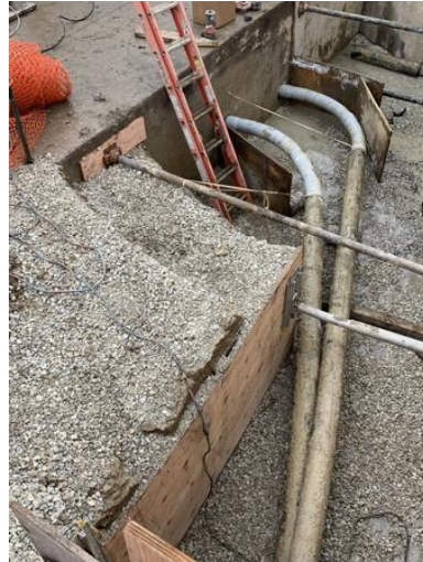
MH-3 buried conduit
