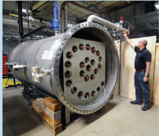
2-MW dc load
